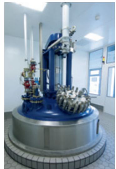
Kristallisationsbehälter für die Wirkstoffaufbereitung
